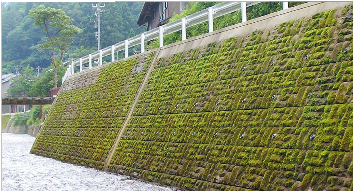
■ 施工後1年10ヶ月経過
